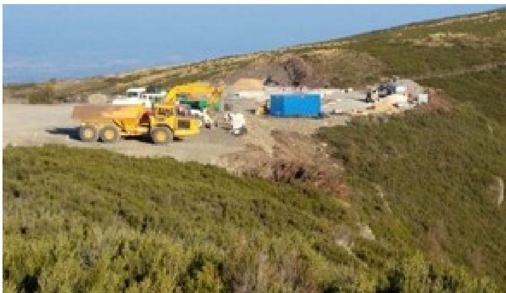
Figura 14.- Fase constructiva del Parque Eólico de la Sierra do Orbio (Lugo) con afección muy significativa sobre hábitats de interés comunitario. Fotografía: ABC: 2019
