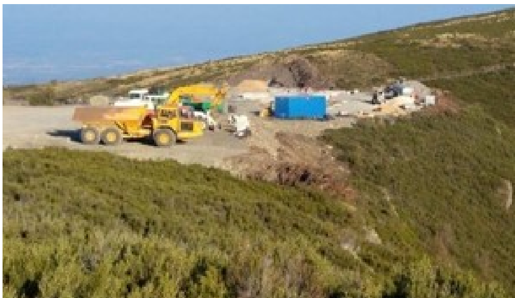
Figura 14.- Fase constructiva del Parque Eólico de la Sierra do Orbio (Lugo) con afección muy significativa sobre hábitats de interés comunitario. Fotografía: ABC: 2019
