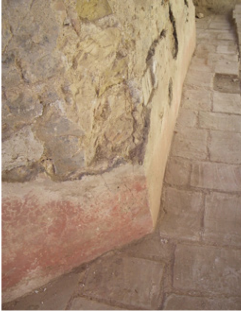
Fig. 13. Arranque exterior de la cúpula, con forma octogonal claramente marcada y revestida con un mortero de cal posiblemente puzolánico. Fotografía del autor, tomada durante los trabajos de restauración, cuando se desmontó el recubrimiento de plomo
