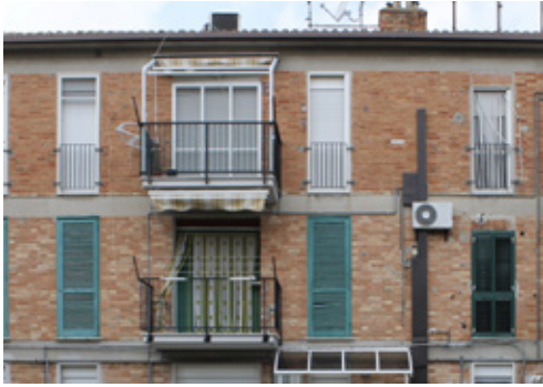
Fig. 8. Matera, quartiere Spine Bianche. Un esempio di alterazione delle aperture sulla facciata di un edificio (Foto De Falco, 2019)
