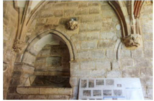
Fig. 5. Santa María de Sasamón. Claustro. Detalle de un arco-solio de la panda oeste tapiado por un arranque de la bóveda. Fotografía de la autora
