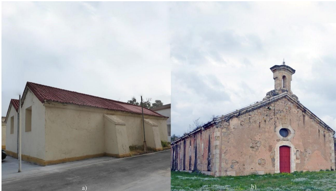
Fig. 11 Almacén de pólvora de Valdeaguas, Ceuta, y almacén de pólvora de Santiago, San Fernando de Figueras
